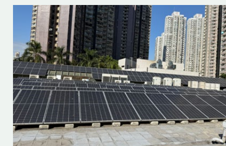
運頭塘商場天台太陽能發電設備
